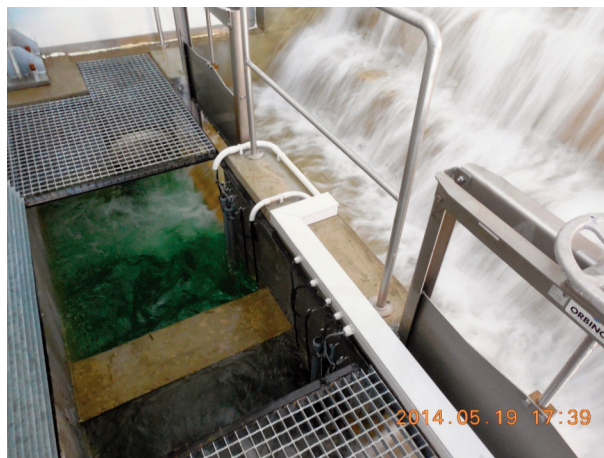
Fig. 5. Stația de tratare a apei potabile Doba: sistem nou de aerare în cascadă (SM-CL-02).
