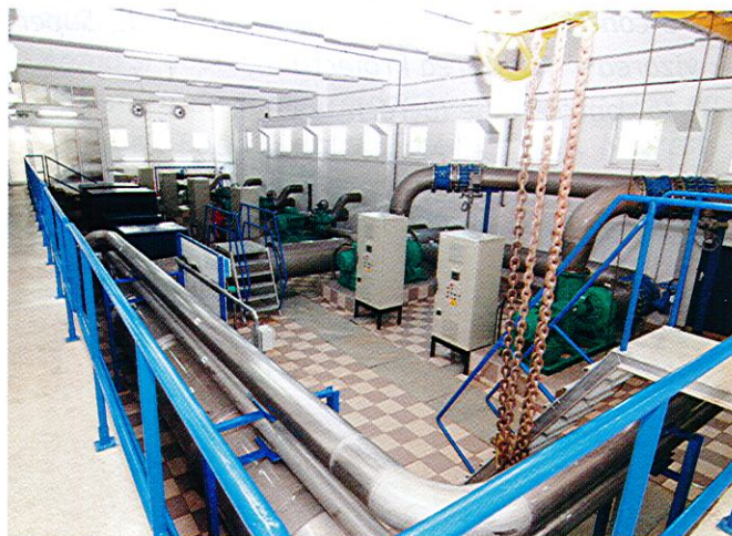
Fig. 3. Stația de pompare de la Uzina Mărtinești.
