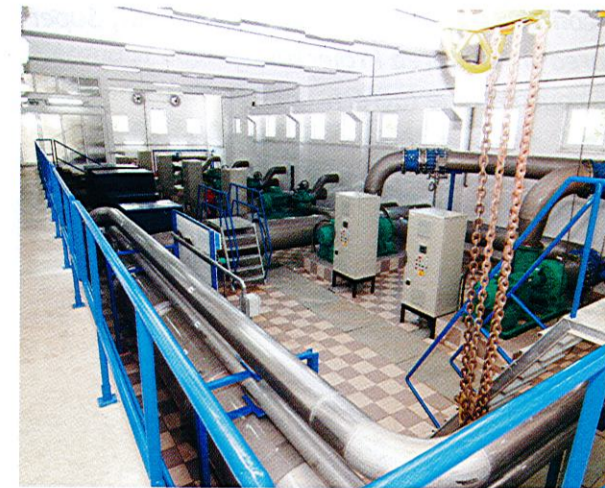
Fig. 3. Stația de pompare de la Uzina Mărtinești.
